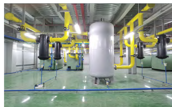
Thiết kế, cung cấp và lắp đặt hệ thống khí nén
