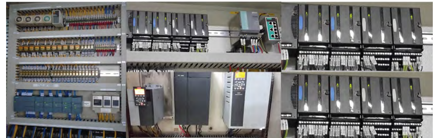
Thiết kế, cung cấp và lắp đặt hệ thống BMS
