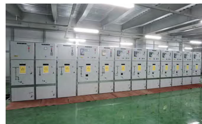
Thiết kế, cung cấp và lắp đặt hệ thống tủ điện trung thế
